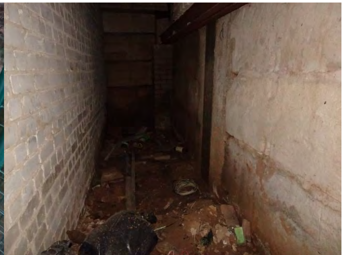
6 pav. Rūsio patalpos nuolatos užliejamos vandens.
