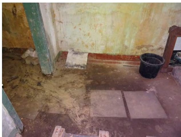
36. Rūsio patalpos nuolatos užliejamos vandens.
