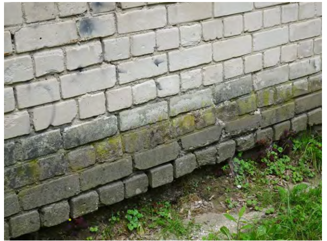
12 pav. Lietaus vandens paplaunami pastato pamatai, sienomis kyla drėgmė.
