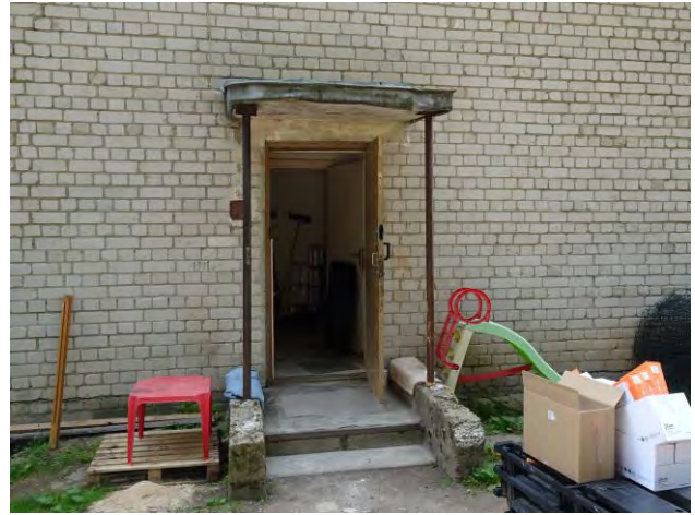
16 pav. Atsarginis įėjimas į pastatą. Susidėvėjęs stogelis virš durų, susidėvėjusi, nelygi laiptų aikštelė ties durimis.
