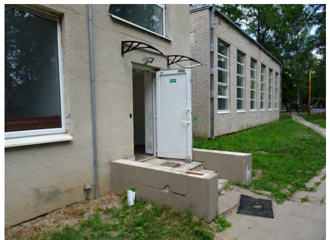
14 pav. Šoninis įėjimas į pastatą. Suiręs stogelis virš durų, atšokę lauko laiptų plytelės.
