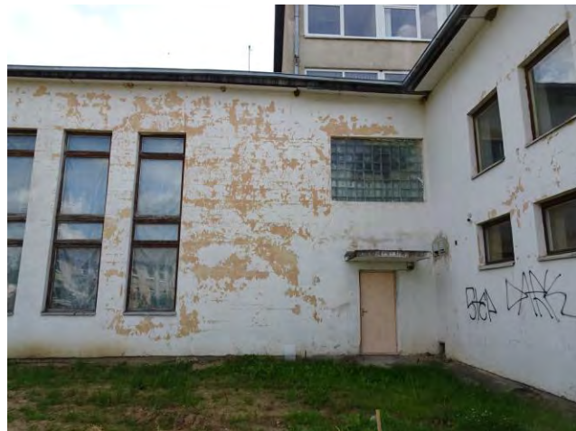
8. Pastato dalies, kurioje yra aktų salė (patalpa 1-33). Drėgmės pažeistas fasadas, atšokę fasadiniai dažai.
