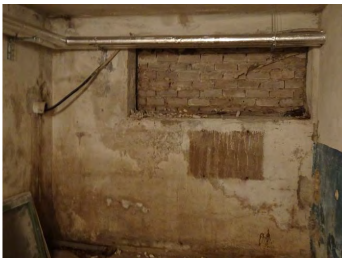
39. Rūsio patalpų sienos veikiamos drėgmės.
