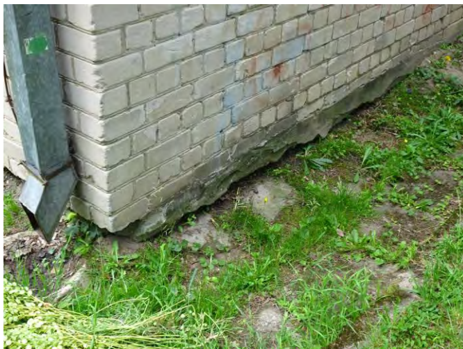
17 pav. Dėl nepakankamo vandens nuo stogo nuvedimo drėkinami pastato pamatai.
