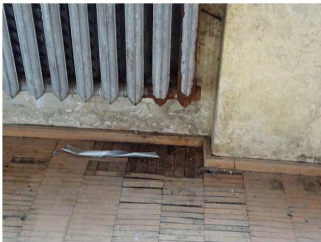
27. pav. Korozijos veikiamas ketinis radiatorius.
