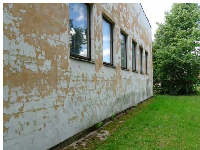
12. Pastato dalies, kurioje yra aktų salė (patalpa 1-33). Drėgmės pažeistas fasadas, atšokę fasadiniai dažai.
