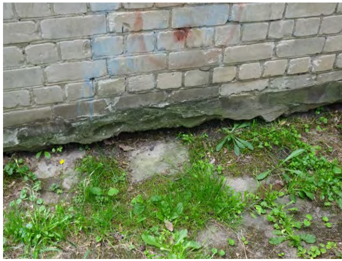
22 pav. Tuštumos nuogrindos ir pamato sankirtoje cokolinėje pastato dalyje.
