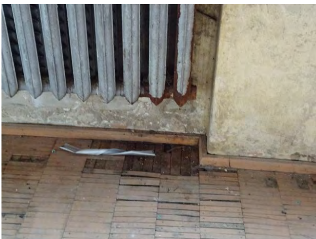
33. Aktų salės patalpoje dėl sienomis kylančios drėgmės puvinio pažeistos medinių grindų konstrukcijos.
