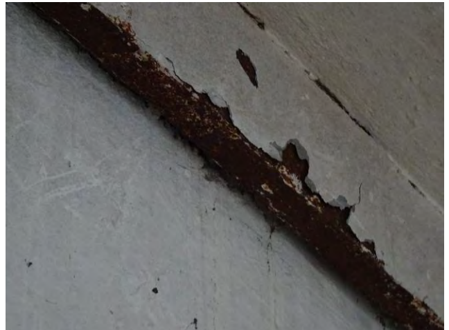
28. Dėl nuolatinės drėgmės korozijos pažeistos metalinės laiptų sijos.
