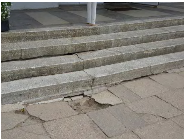
13 pav. Susidėvėję, deformuoti išoriniai pastato laiptai.
