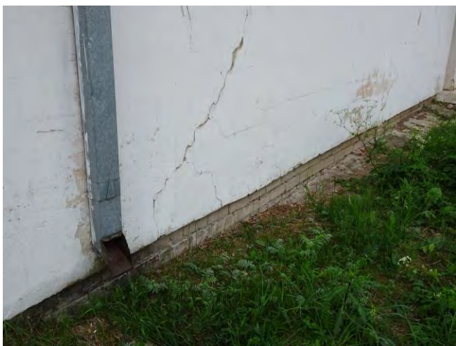
45. Dėl nepakankamo vandens nuvedimo paplaunamų pamatų formuojasi sienų deformacijos, tai patvirtina atsiradę plyšiai sienose.
