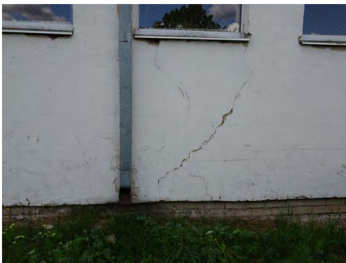
23 pav. Dėl nepakankamo vandens nuvedimo ir dėl to paplaunamų pamatų formuojasi sienų deformacijos, tai patvirtina atsiradę plyšiai sienose.
