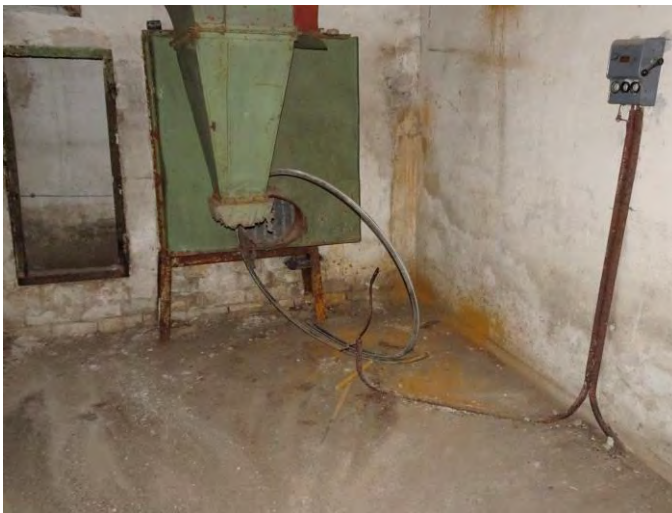
25. pav. Įranga rūsių patalpose susidėvėjusi, pažeista korozijos.
