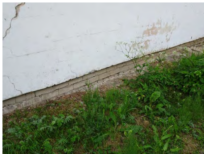
46. Dėl paplovimo nusėdusi betoninė nuogrinda.
