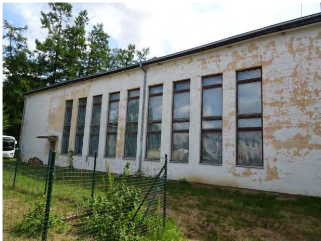
7. Pastato dalies, kurioje yra aktų salė (patalpa 1-33). Drėgmės pažeistas fasadas, atšokę fasadiniai dažai.
