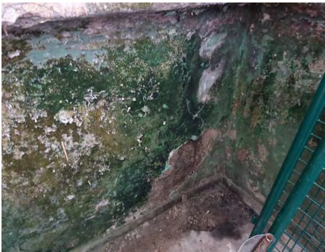
5 pav. Rūsio patalpose sienos pažeistos drėgmės ir pelėsio.
