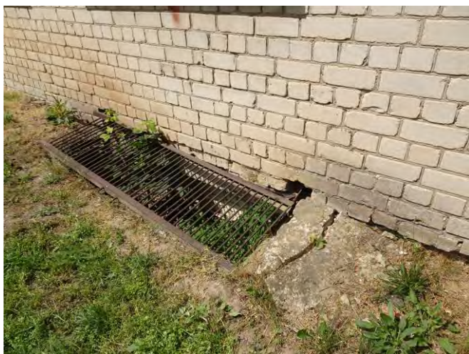
17. Deformuota, nusėdusi nuogrinda ir šviesduobė. Gruntas ties pastato pamatais paplautas, nusėdęs.
