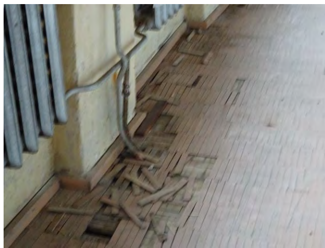
34. Aktų salės patalpoje greta išorinių sienų puvinio pažeistos medinių grindų konstrukcijos.
