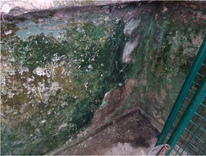
25. Rūsio patalpose sienos pažeistos drėgmės ir pelėsio.
