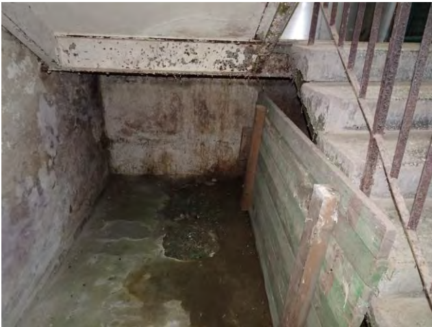
27. Dėl susidėvėjusios pamatų hidroizoliacijos rūsio patalpose kaupiasi vanduo.
