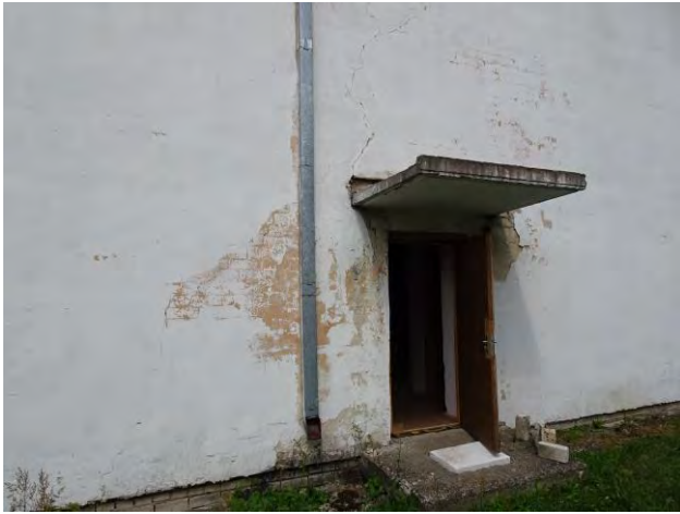
15 pav. Atsarginis įėjimas į pastatą. Susidėvėjęs stogelis virš durų, susidėvėjusi ir nusėdusi laiptų aikštelė ties durimis.
