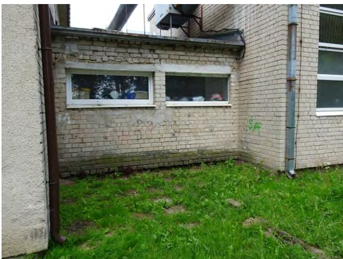
5. Sankirta tarp pastato dalių - virš patalpos 1-57 lango matomas erozijos pažeistas mūras. Išorinė siena veikiamą drėgmės.
