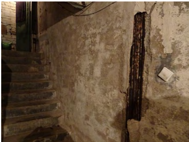
37. Rūsio patalpų sienos veikiamos nuolatinės drėgmės. Matomi korozijos pažeisti metaliniai elektros kabelių vamzdžiai.
