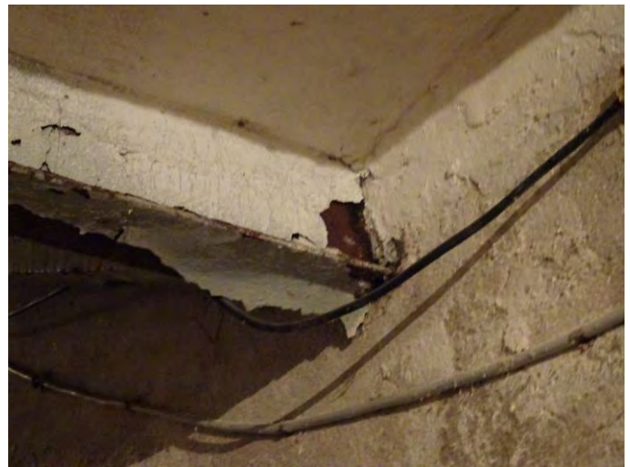
26. pav. Kabeliai rūsių patalpose praeina sienų paviršiumi.
