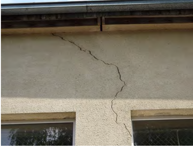
9 pav. Vertikalus plyšys pastato sienoje ties langų angomis.
