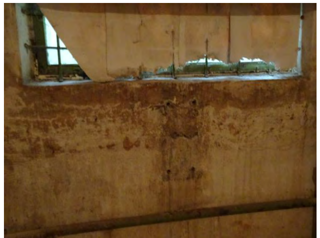
30. Rūsio patalpų sienos veikiamos nuolatinės drėgmės.
