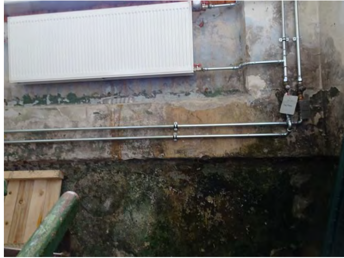
26. Rūsio patalpose sienos pažeistos drėgmės ir pelėsio.
