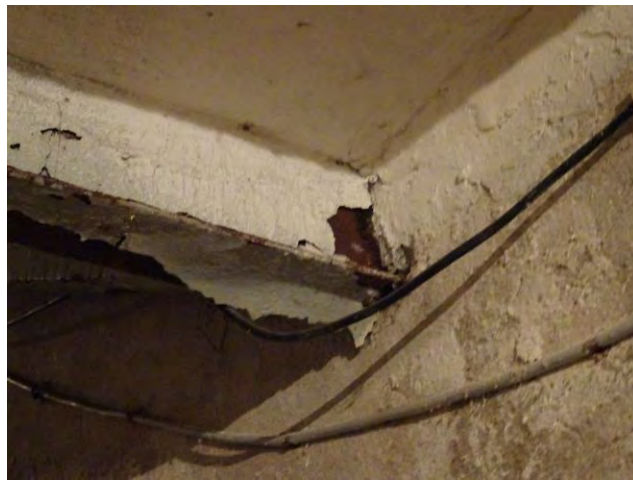
38. Laiptų į rūšį metalinės konstrukcijos veikiamos korozijos.
