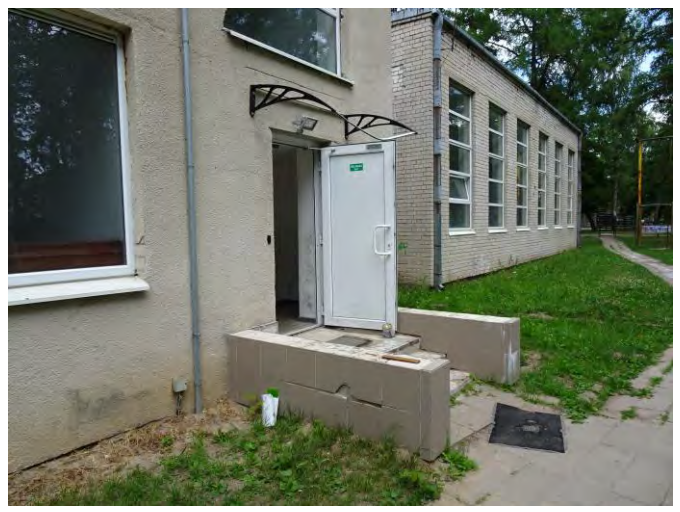
6. Šoninis įėjimas į pastatą. Suiręs stogelis virš durų, atšokę lauko laiptų plytelės.
