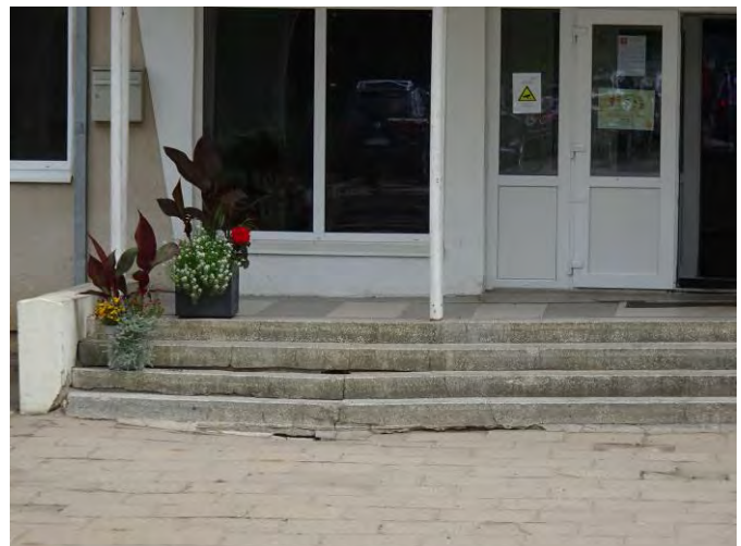
18 pav. Dėl vandens paplovimo nusėdę išoriniai pastato laiptai ir betoninių plytelių prieš laiptus dangas.
