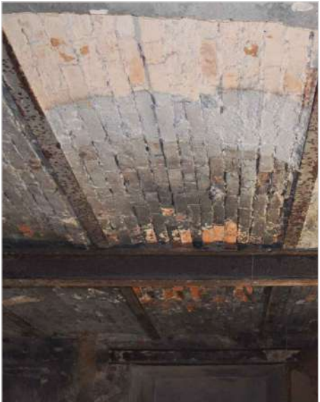
Avarinės būklės metalinės dvitėjinės sijos.
