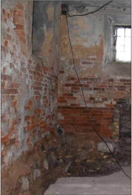
Restauruojamas eroduotas keraminių plytų mūras - drėgnas ir užterštas tirpiomis druskomis
