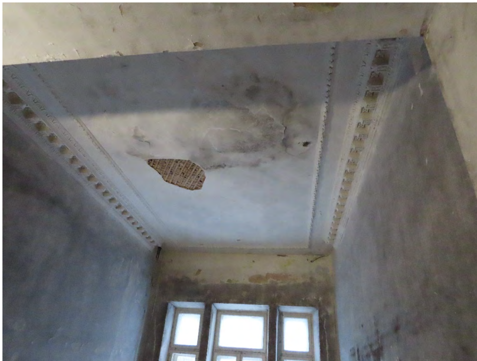
47. Stogo pratekėjimų vietose medinės perdangos konstrukcijos pažeistos drėgmės ir puvinio, pažeistas tinkas atsokęs nuo pagrindo ir vietomis nukritęs.
