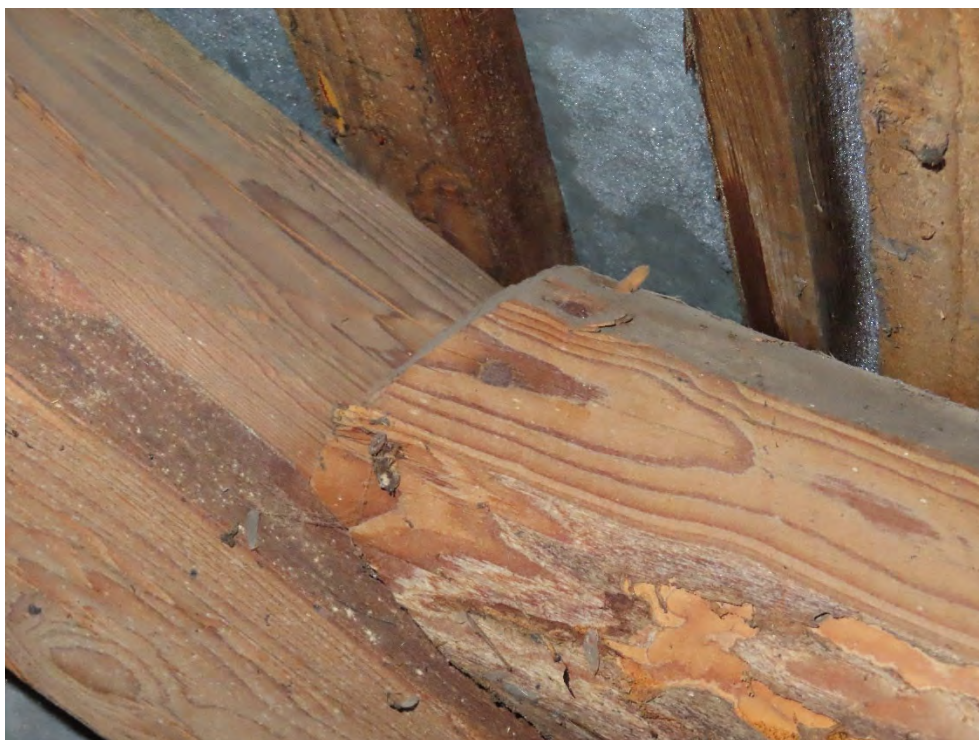
72. Stogo remonto metu medinės konstrukcijos įrengtos ne kokybiškai, be įpjovų, tarpusavyje mediena sujungta keliais vinimis.
