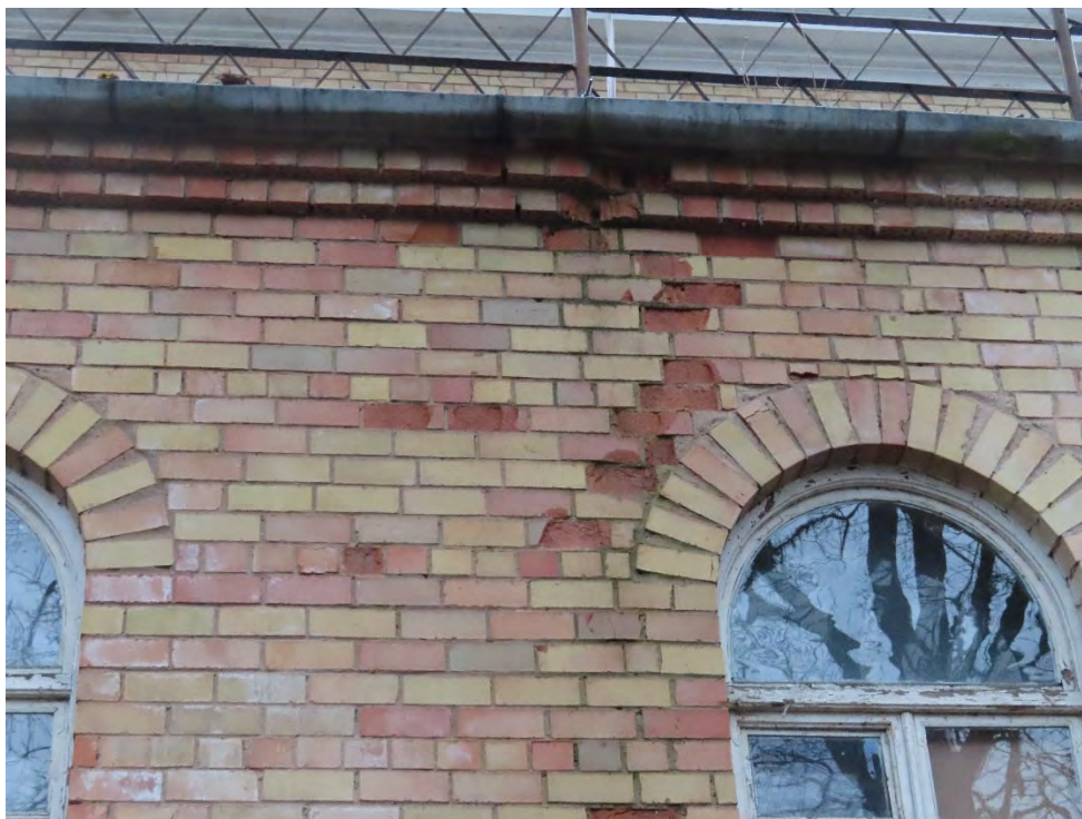
13. Dėl netinkamo terasos hidroizoliacinio sluoksnio ir netvarkingo kritulių nuvedimo, XX a. antros pusės priestato sienos mūras šlapias, keraminės skylėtos plytos ištrupėjusios.
