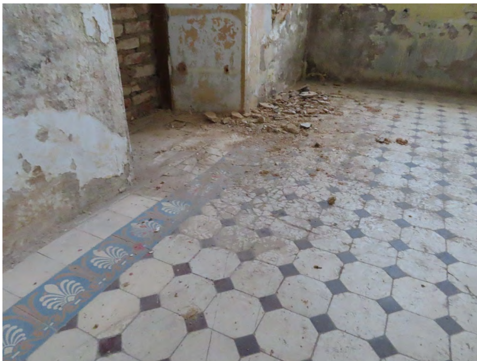
38. Pirmo aukšto patalpoje tarp ašių 6-7 ir C-D, grindų konstrukcija ties durų anga pasėdusi, metlacho plytelės sutrūkinėjusios ir atšokusios nuo pagrindo, fragmentai suskaldyti, būtina keisti naujais gaminiais.
