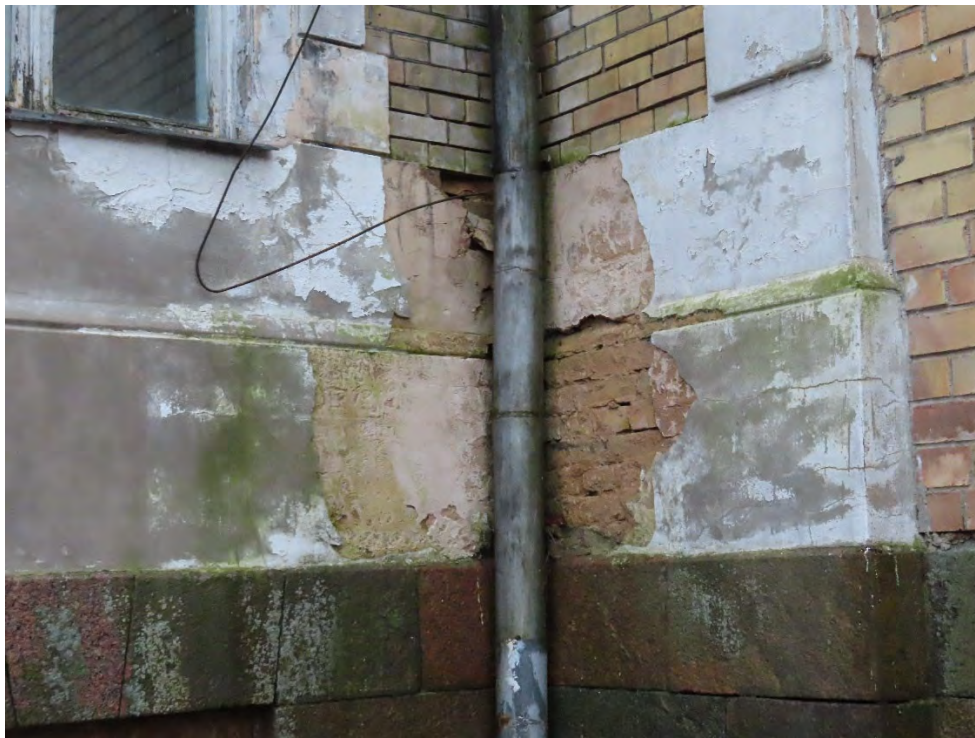
15. Sienų mūras įmirkęs lietvamzdžių vietoje, tinkas pažeistas drėgmės, nerišlus ir ištrupėjęs.
