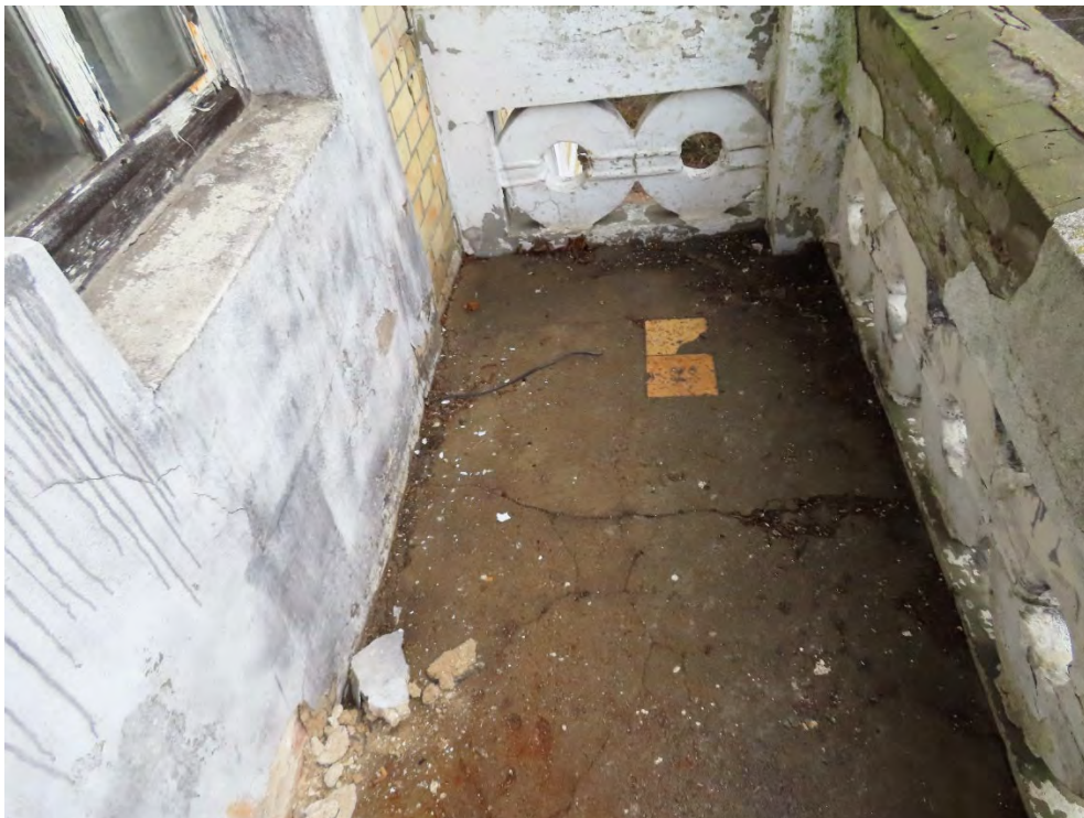
55. Balkono grindų betonas sutrūkinėjęs ir ištrupėjęs. Betoninio ornamentuoto turėklo viršutinės dalies betonas suskilinėjęs, vietomis ištrupėjęs.
