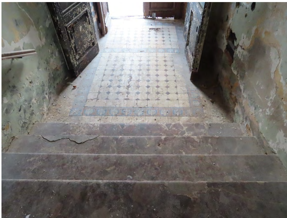
35. Koridoriaus patalpoje laiptų pakopos betoninės su 4 cm betoninėmis marmurą imituojančiomis antpakopėmis. Antpakopės vietomis sutrūkinėjusios, atskilusios vietos nekokybiškai remontuotos remontiniu betonu.
