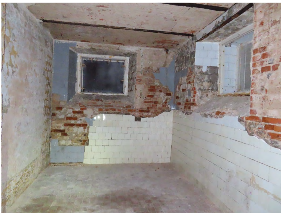
28. Pamatai įrengti be vertikalios hidroizoliacijos, pusrūsio lauko sienų mūras iki 0,5 plytos storio eroduotas, mūras drėgnas ir užterštas tirpiomis druskomis, dalis plytelių apdailos nukritusi. Perdangos metalinės sijos stipriai pažeistos korozijos.
