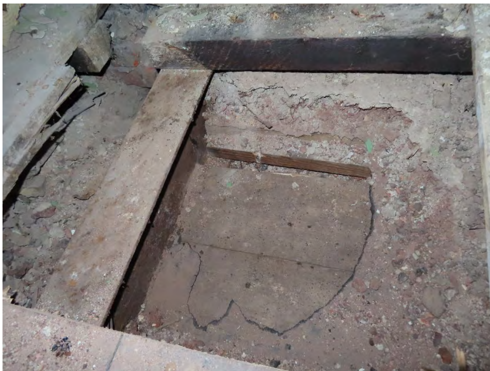
52. Zondažas nr.5. Pirmo aukšto perdanga gelžbetoninė ~10cm perdanga įrengta tarp metalinių 240(h)x115 mm sijų. Ant perdangų įrengtas ~150 mm keramzito ir statybinio laužo užpildas. Ant metalinių sijų įrengti 100(h)x70 mm gulekšniai ir 30 mm grindinių lentų paklotas.
