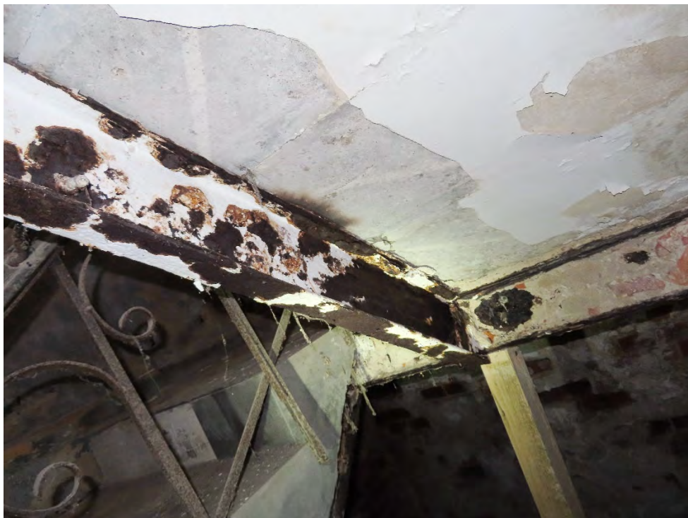
16. Šoninės laiptinės laiptai iš surenkamų betoninių pakopų atremtų ant metalinių 150x70 mm laiptasijų. Laiptasijos stipriai pažeistos korozijos ir sumažėjusio tūrio. Laiptasijos šiuo metu išramstytos papildomais mediniais spyriais.
