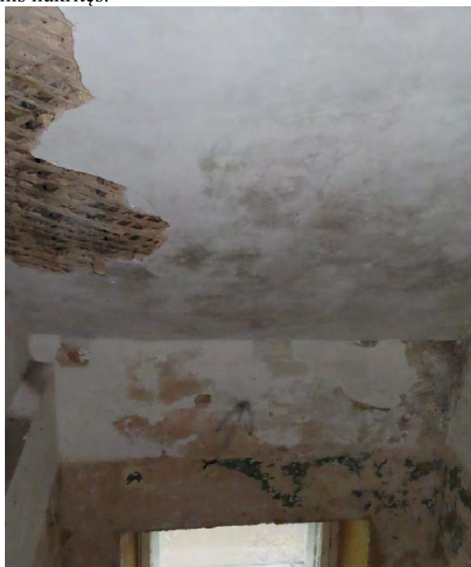
58. Laiptinės dalyje dėl stogo pratekėjimų medinės perdangos konstrukcijos ir paklotai pažeisti drėgmės ir puvinio, pažeistas tinkas atšokęs nuo pagrindo ir nukritęs.
