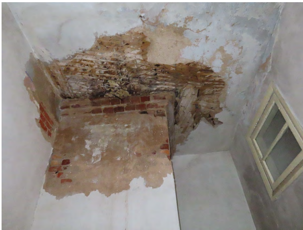
57. Stogo pratekėjimo vietoje ties dūmtraukiu, medinės perdangos konstrukcijos ir paklotai pažeisti drėgmės ir puvinio, pažeistas tinkas atšokęs nuo pagrindo ir vietomis nukritęs.
