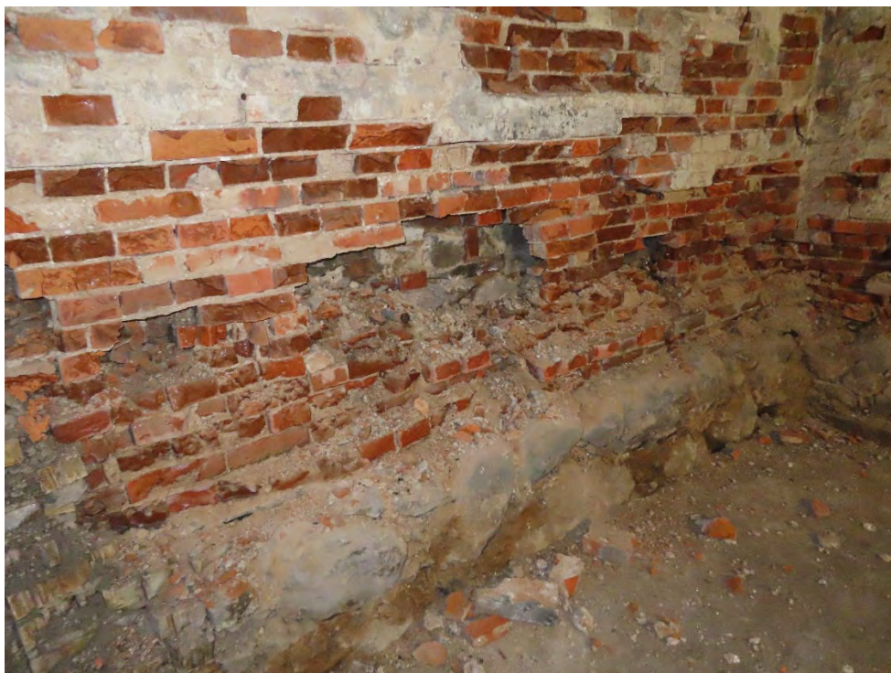
19. Pamatai įrengti be vertikalios hidroizoliacijos, pusrūsio lauko sienos mūras iki 1-2 plytų storio eroduotas, mūras drėgnas ir užterštas tirpiomis druskomis.
