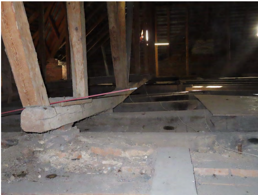
67. Stogo atrėmimo vietoje įlinkusi pastogės perdangos konstrukcija, įlinkiai siekia ~20-25 cm.
