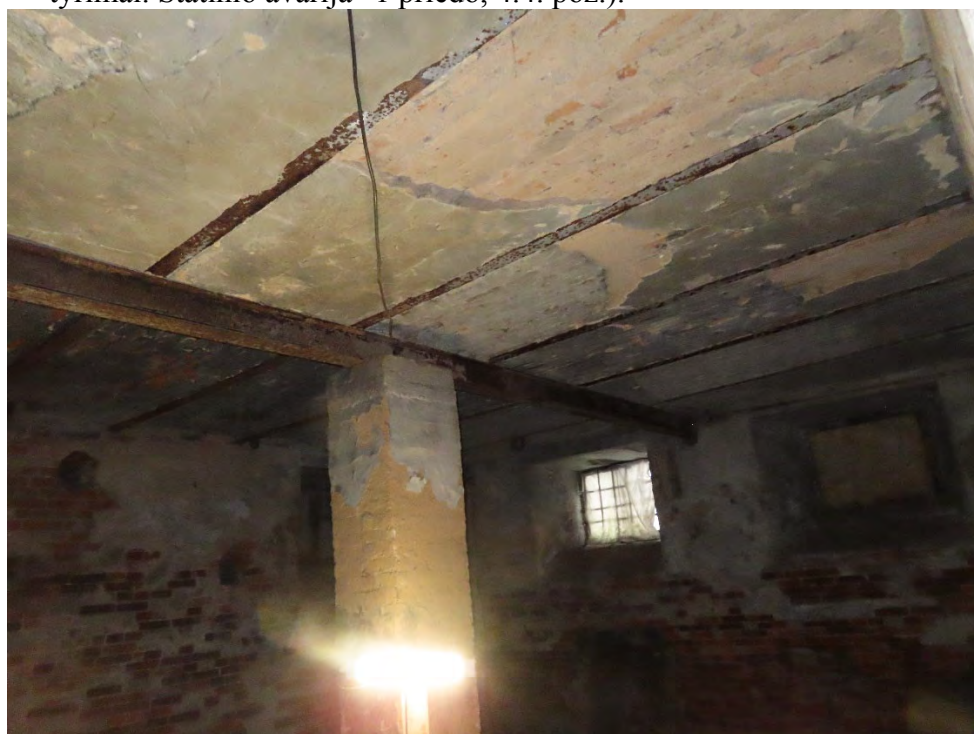
18. Pusrūsio perdanga tarp ašių 3-4 ir C-D tinkuotų mūrinių skliautukų tarp metalinių sijų. Perdanga patalpos viduryje atremta ant 2/180x90 mm metalinių lovių ir mūrinių kolonų. Metalinės sijos stipriai pažeistos korozijos.
