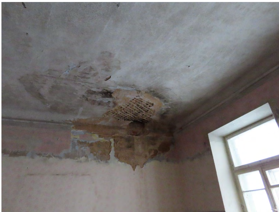
51. Stogo pratekėjimų vietose medinės perdangos konstrukcijos ir paklotai pažeisti drėgmės ir puvinio, pažeistas tinkas atšokęs nuo pagrindo ir vietomis nukritęs.
