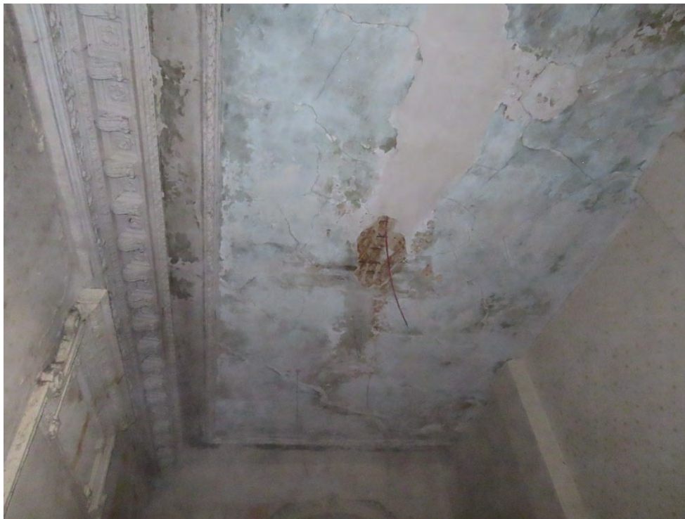
41. Atskirų patalpų lubose išlikę gipsiniai puošybos elementai. Pirmo aukšto perdanga medinė, tinkuota ant balanų. Tinkas drėgnas, sutrūkinėjęs ir atšokęs nuo pagrindo.
