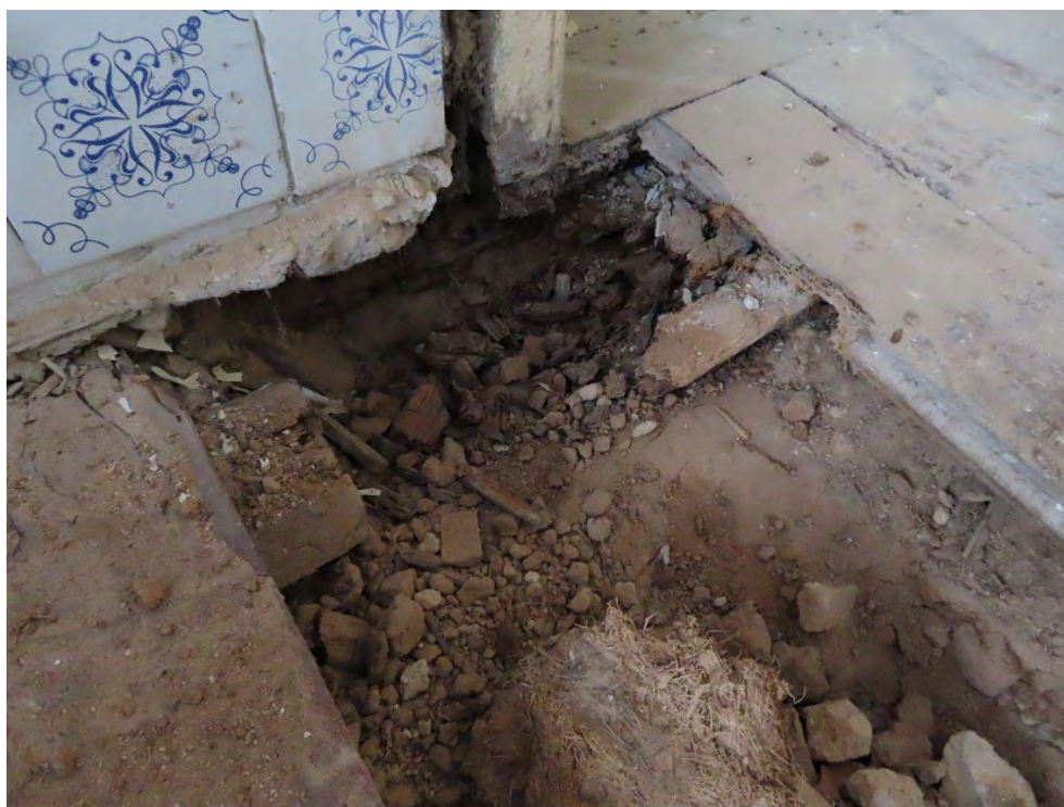
50. Zondažas nr.4. Visiškai supuvusi medinės perdangos sija ~280(h)x220 mm. Tarp sijų įrengtas molio ir statybinio laužo užpildas. Ant perdangos sijų įrengtos grindinės lentos vietomis pažeistos puvinio, grindų konstrukcija įlinkusi.
