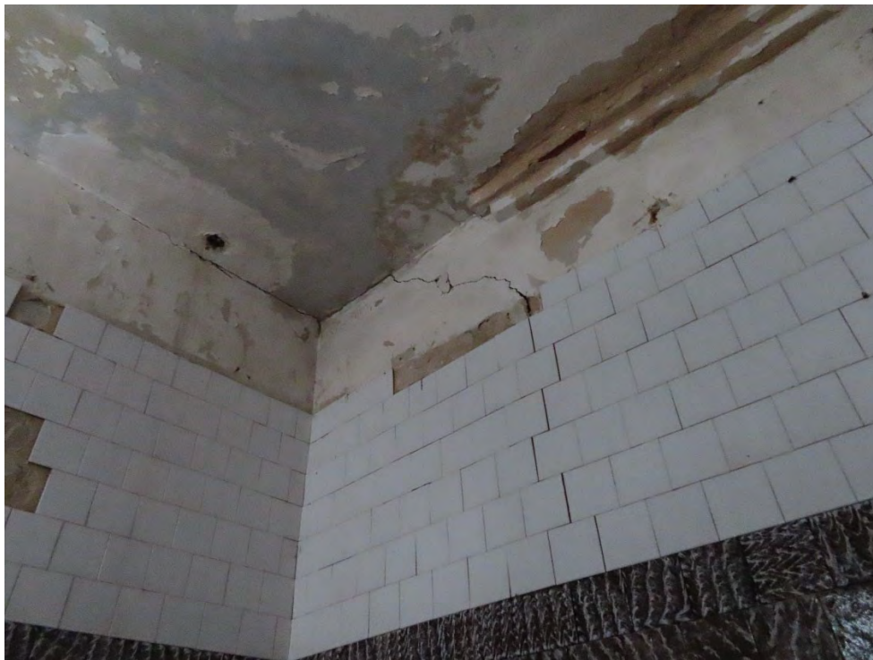
53. Dėl gelžbetoninės perdangos įlinkių, ant perdangos besiremiančios pertvaros pasėdusios ir sutrūkinėjusios.
