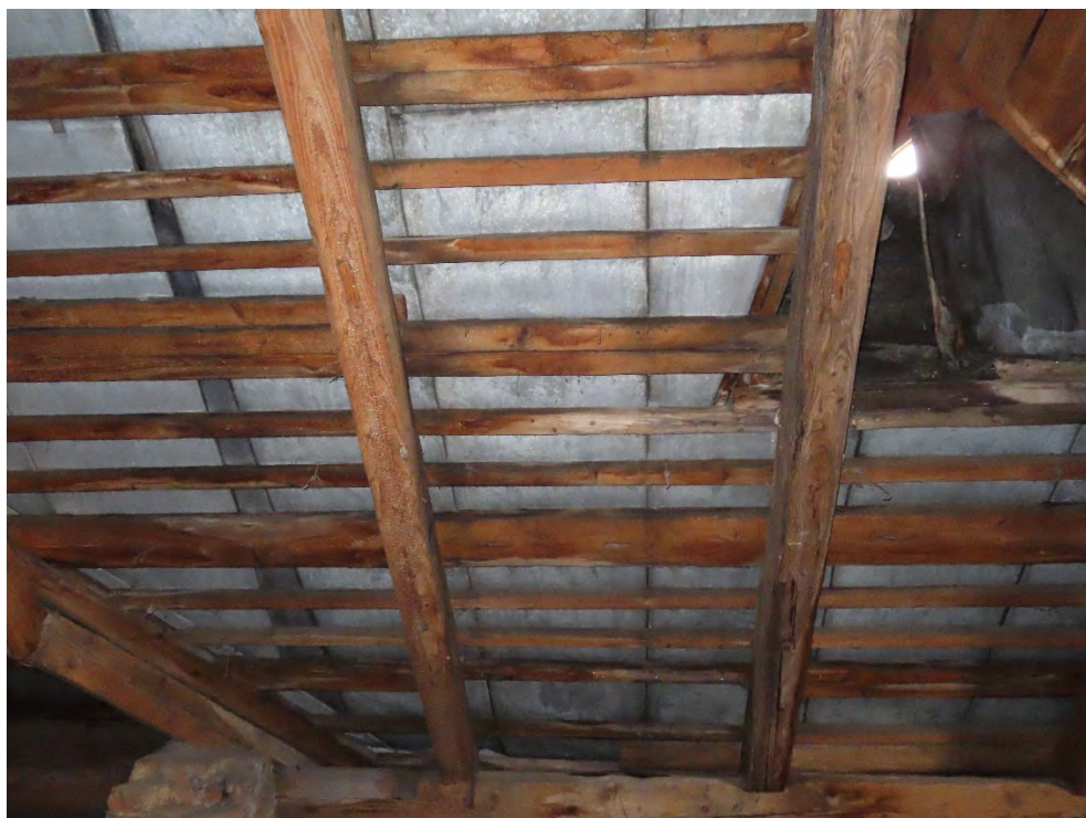
68. Medinės stogo konstrukcijos ties stoglangiu ir karnizu pažeistos puvinio. Nėra įrengta garo izoliacinė plėvelė, besikaupiantis kondensatas ant stogo dangos drėkina stogo medines konstrukcijas.
