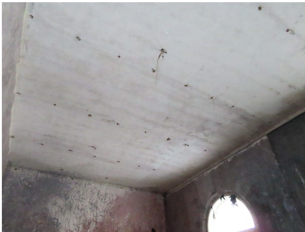
40. Sovietmečio laikotarpiu įrengto priestato tarp ašių I-J perdanga gelžbetoninės su metalinėmis sijomis išdėstytomis ~1,0-1,1 m žingsniu. Metalinių sijų vietose perdangos betonas sutrūkinėjęs.
