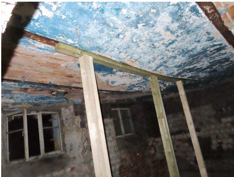
17. Pusrūsio perdanga tarp ašių 3-4 ir C-D tinkuotų mūrinių skliautukų tarp metalinių sijų. Metalinės sijos stipriai pažeistos korozijos ir sumažėjusio tūrio. Dėl metalinių sijų pažeidimų, perdangos konstrukcija stipriai išlinkusi (25-30 cm) ir turi avarinės būklės požymių pagal STR 1.03.01:2016 „Statybiniai tyrimai. Statinio avarija“ 1 priedo, 4.4. poz.).
