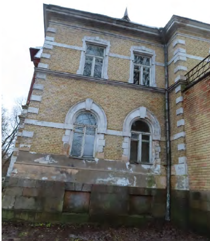
14. Rūmų cokolinė dalis mūrinė tinkuota, su tašyto granito luitų apdaila. Tinkas pažeistas drėgmės, nerišlus ir byra. Granito luitų siūlės ištrupėjusios.
