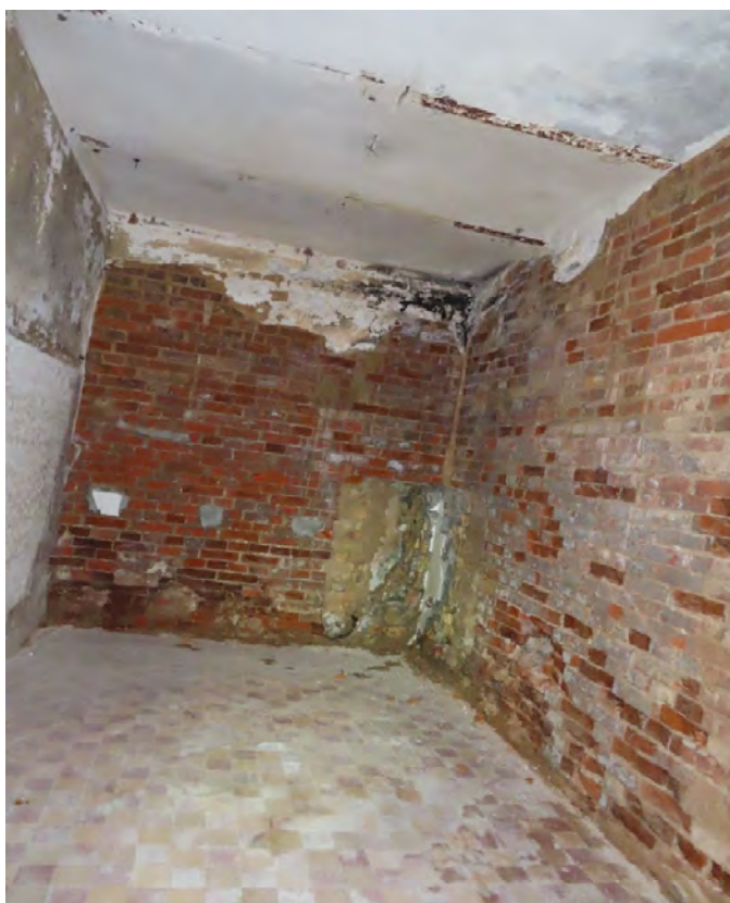
23. Pamatai įrengti be vertikalios hidroizoliacijos, pusrūsio lauko sienų mūras iki 0,5-1 plytos storio eroduotas, mūras drėgnas ir užterštas tirpiomis druskomis. Perdangos metalinės sijos pažeistos korozijos.
