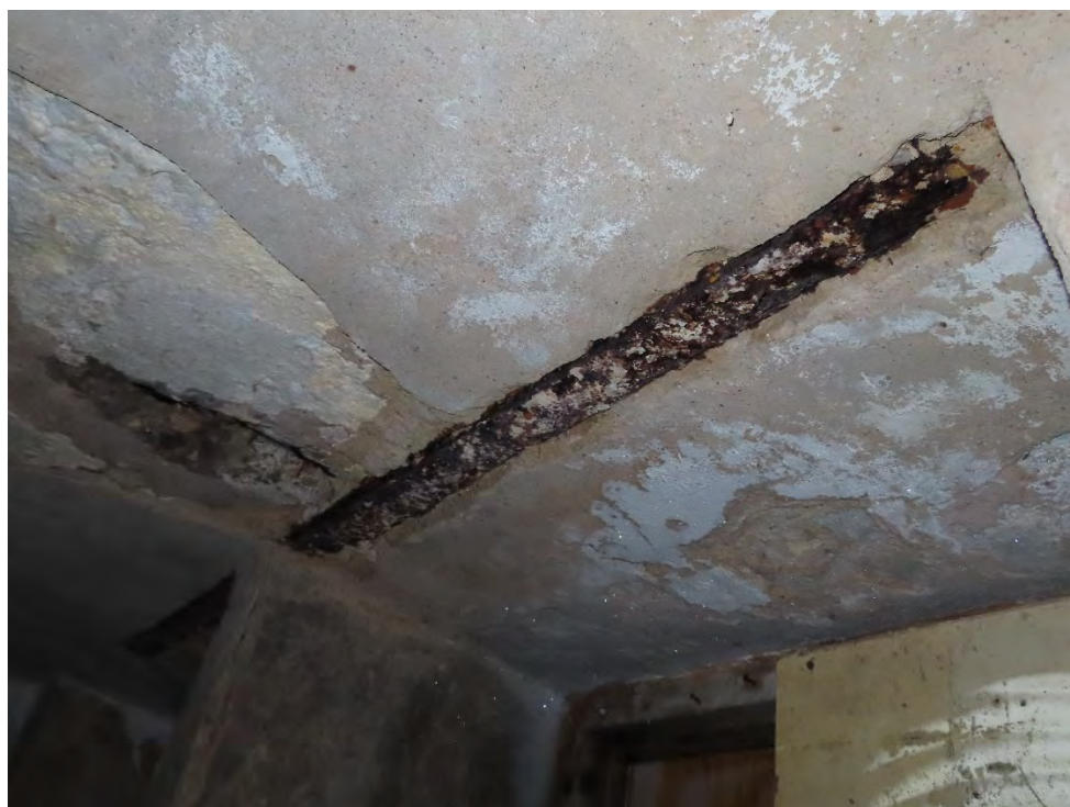
20. Pusrūsio perdangos metalinės sijos stipriai pažeistos korozijos ir sumažėjusio tūrio. Perdangos metalinės konstrukcijos turi avarinės būklės požymių pagal STR 1.03.01:2016 „Statybiniai tyrimai. Statinio avarija“ 1 priedo, 4.4. poz.).
