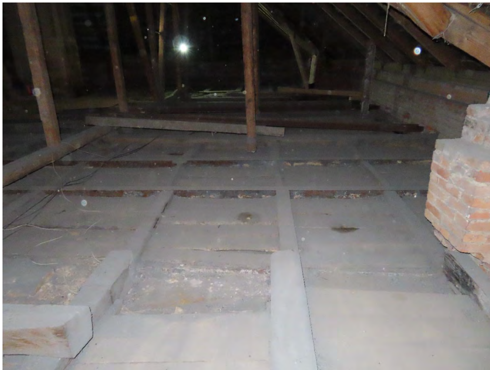
61. Remonto metu pakeistos medinės perdangos sijos, vietomis įrengtos 220(h)x110 mm metalinės dvitėjinės sijos. Stogo atrėmimo vietoje įlinkusi pastogės perdangos konstrukcija, įlinkiai siekia ~20-25 cm.
