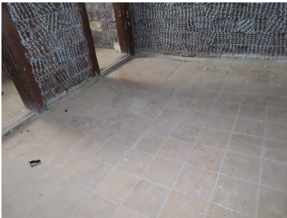
44. Avarinės būklės požymių turinčios perdanga pasėdusi ~15-20 cm. Ant perdangos besiremiančios pertvaros pasėdusios ir sutrūkinėjusios.
