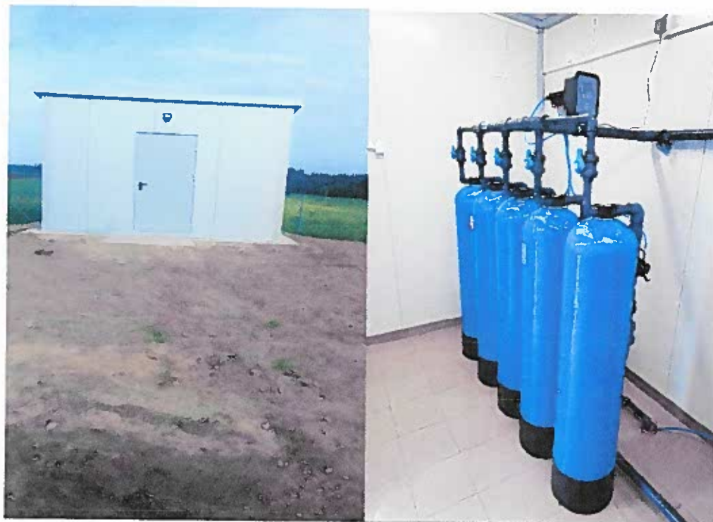
2 pav. Padabčių k. vandens gerinimo įrenginiai
